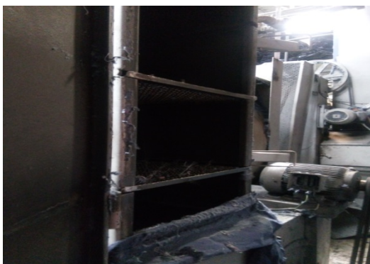
Fotografía 5. Sistema de control secadora
